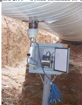
Figura 2.10 – Sonda instalada no duto
