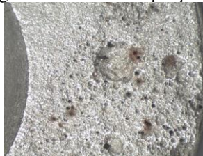
Figura 2.4 – Corrosão por pitting
