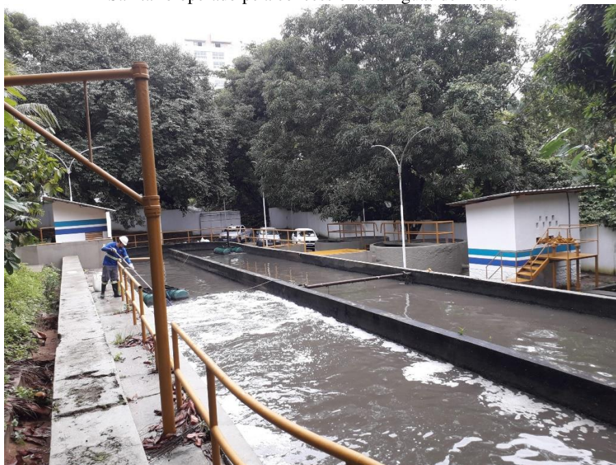
Figura 7 Estação elevatória e de tratamento de esgoto que compõem o Sistema Público de Esgotamento Sanitário operado pela concessionária Águas de Manaus
